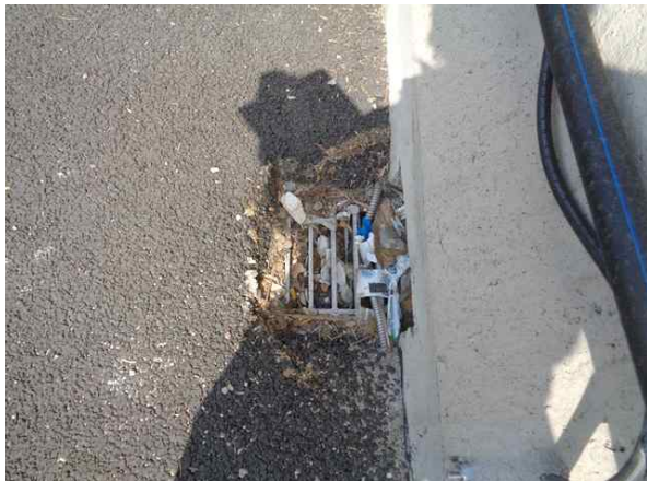
배수시설 S3 배수구 토사퇴적
