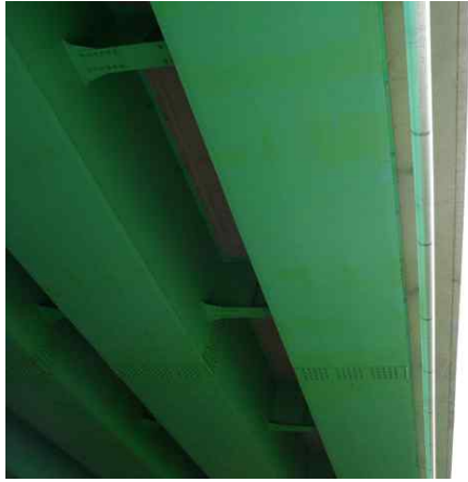
바닥판 하면 S1 상태양호
