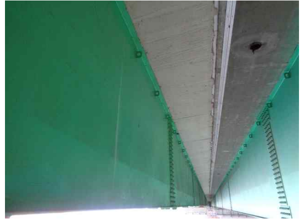
바닥판 하면 S2 상태양호
