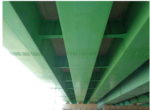
바닥판 하면 S4 상태양호
