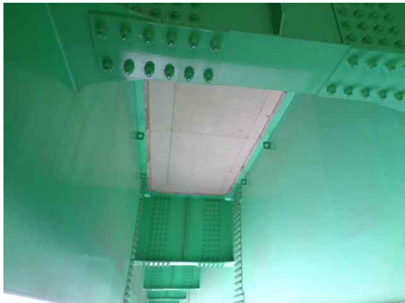
바닥판 하면 S3 상태양호
