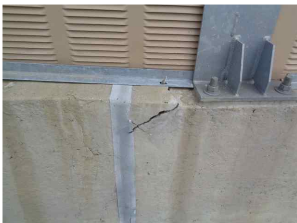
방호벽 S1 접속부 파손(0.2×0.2)
